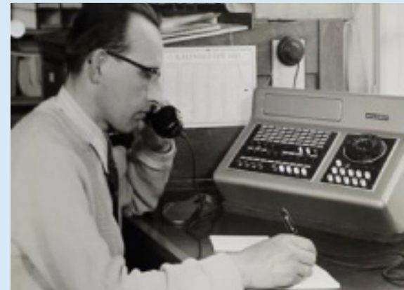
Zentrale einer Nebenstelle zur Vermittlung von Telefonaten, wie sie bei größeren Unternehmen oder Ämtern üblich war (ca. 1960)
